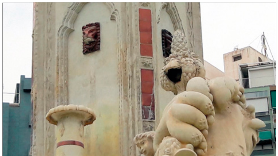
Figura 1. Detalle de desprendimiento de cemento en dos figuras por oxidación de las armaduras.
