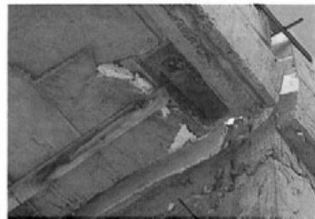
▲ La brecha. La junta de dilatación de 20 centímetros del viaducto con el estribo situado en Cuenca. DAMIÁN TORRES
